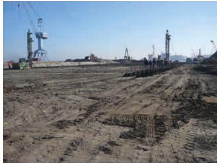
Erdbau und Munitionssondierung in einem maritimen Gewerbegebiet in Rostock zählen zu den Aufträgen der Wastra-Plan Ingenieurgesellschaft mbH. | Foto Dr. Joachim Koop
