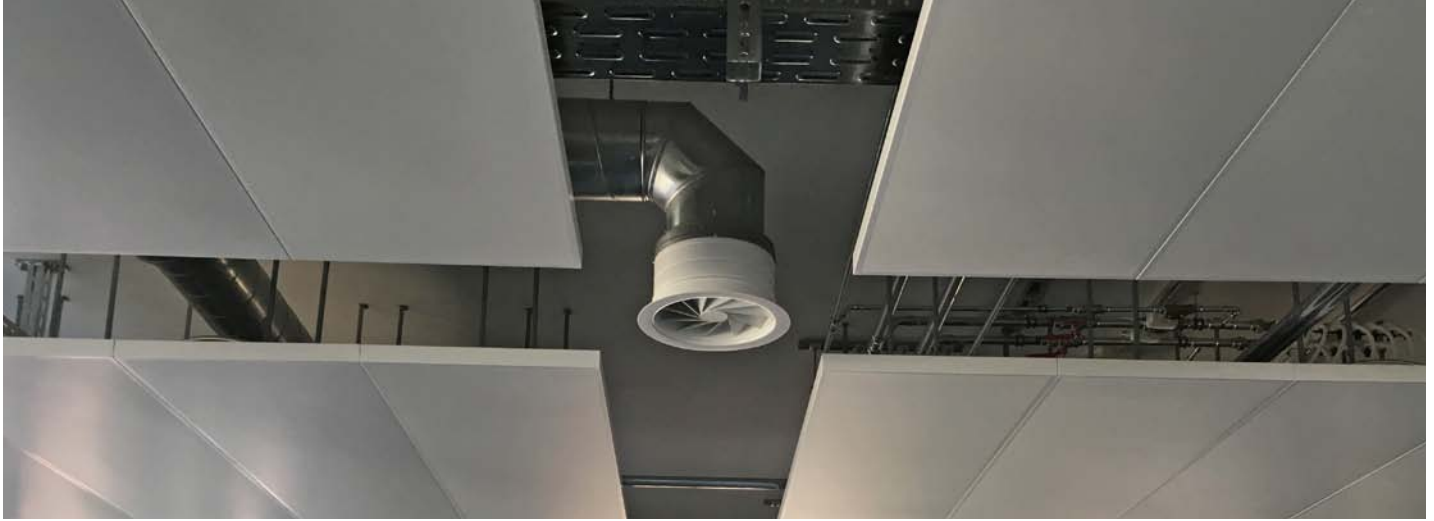
Schallabsorbierendes Heiz-Kühlsegel-System in Sichtinstallation in einem Bürogebäude
