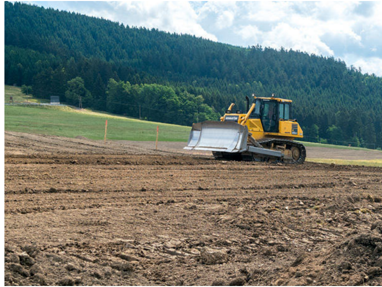
Renaturierung von Deponieflächen der Deutschen Bahn am Fuße des Blesberges. Vorhandener Oberboden wird in verschiedenen Schichten mit Großgeräten wie Kettenbagger, Raupe und Lkw aufgebracht. Ziel der Maßnahme: Begrünung mit autochthonem Saatgut und Heumulchübertragung sowie Pflanzung gebietsheimischer Gehölze und Heister. | Fotos: Stefan Weigelt, Neuhaus
