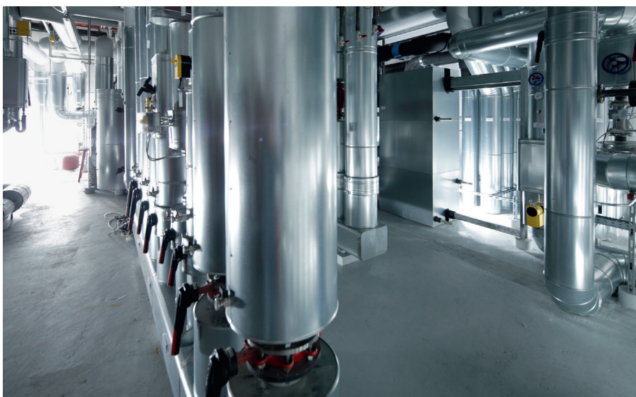
Abb. 1: Heizungszentrale im Neubau des Büro- und Gewerbegebäudes MÜ15 von Rohde & Schwarz in München.
