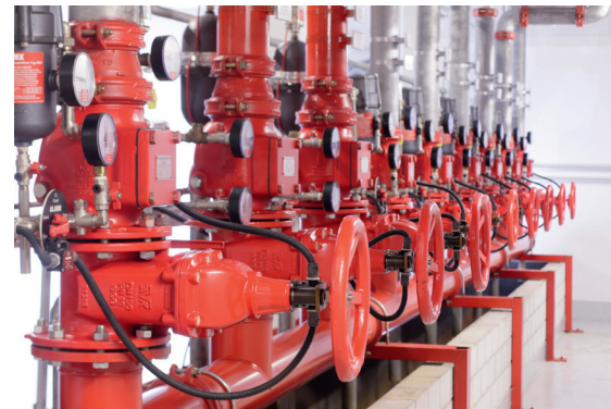
Abb. 2: Sprinklerzentrale im Neubau des Büro- und Geschäftsgebäudes MÜ4 in München.
