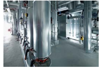
Heizungszentrale im Neubau Büro- und Gewerbegebäude MÜ15 von Rohde & Schwarz in München
