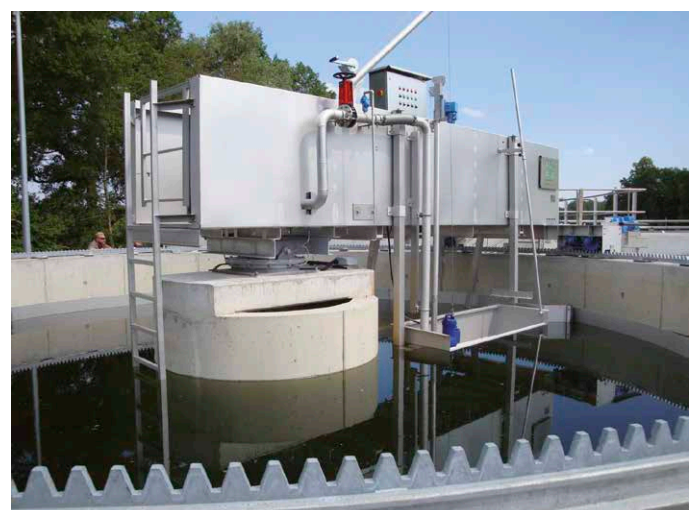
Abb. 4: Kläranlage Schwepnitz, Nachklärbecken Ausrüstung.
