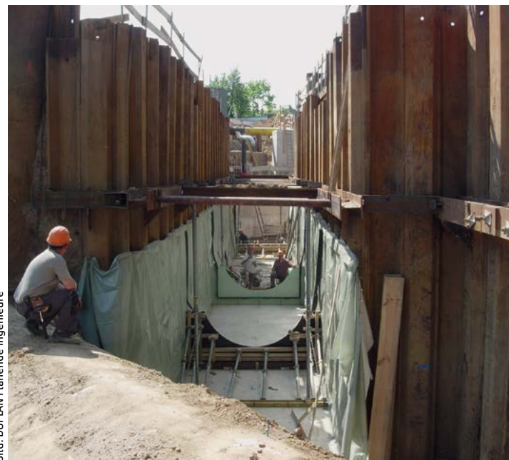
Abb. 2: Zulauf des Transportsammlers in Köln-Porz.
