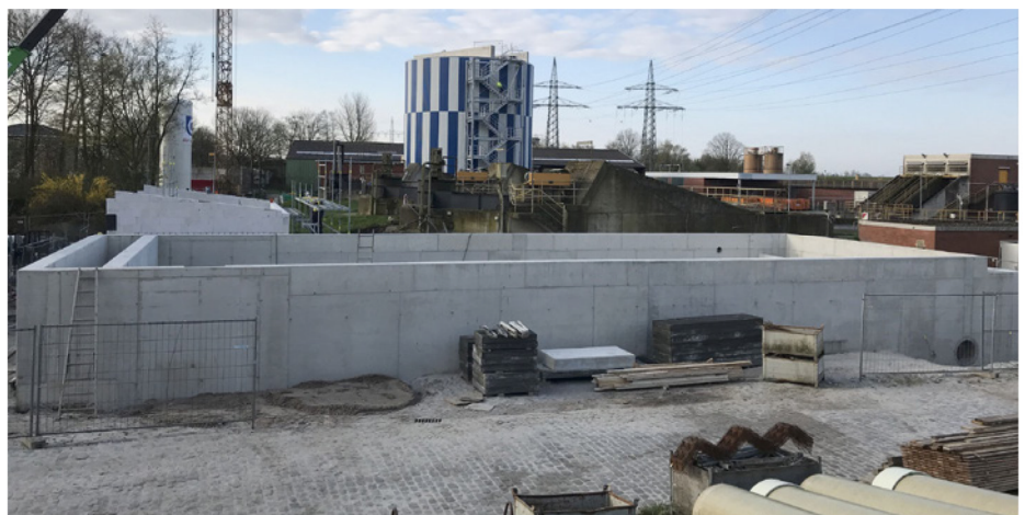
Nach der Fertigstellung des Faulturms mit Vorklärung können Klärschlamm, Stromverbrauch der Kläranlage und CO 2 reduziert werden. | Fotos: Stadtwerke Leer AöR
