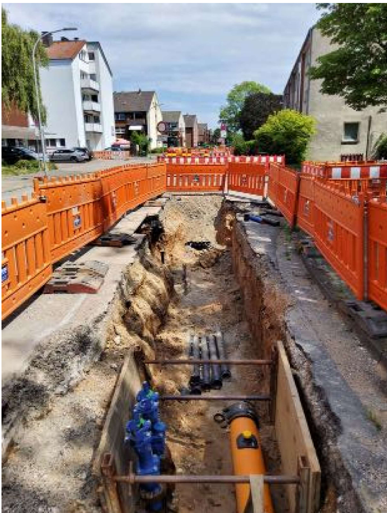
Abb. 1: Tiefbauarbeiten für Wasser-/Gas-/MSP-/NSP-/ und TK-Netz im Zuge einer Straßensanierung in der Mozartstraße in Neukirchen-Vluyn. Bild: ENNI Energie & Umwelt Niederrhein
